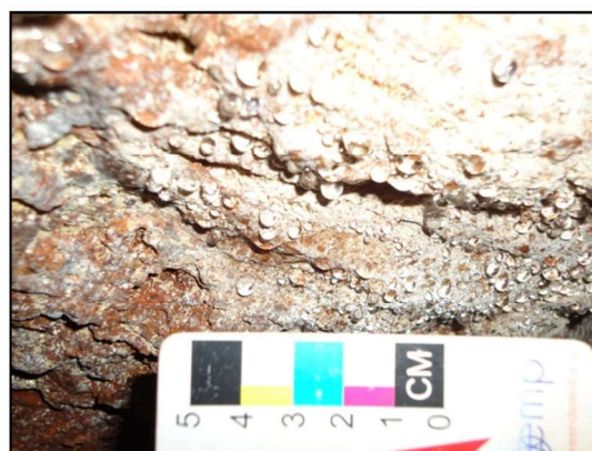
Figura 32: Interior da cavidade apresenta crosta branca e condensação.
