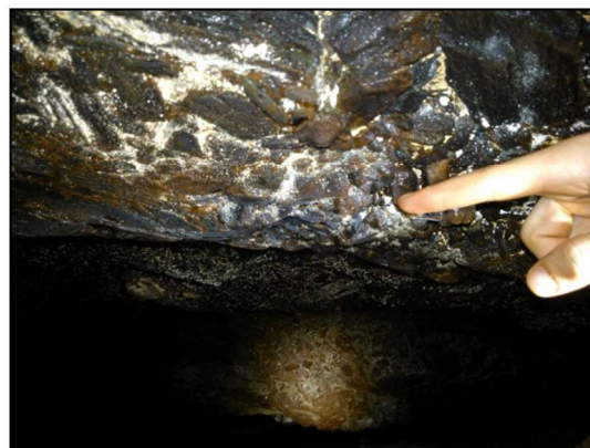
Figura 44: Detalhe do teto evidenciando crosta branca.
