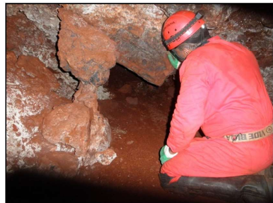
Figura 148: Pilar com pouca sustentação e pendente próximo.
