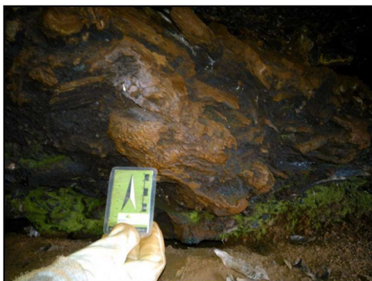
Figura 59: Crosta de óxido-hidróxido avermelhados nas pontas dos blocos.
