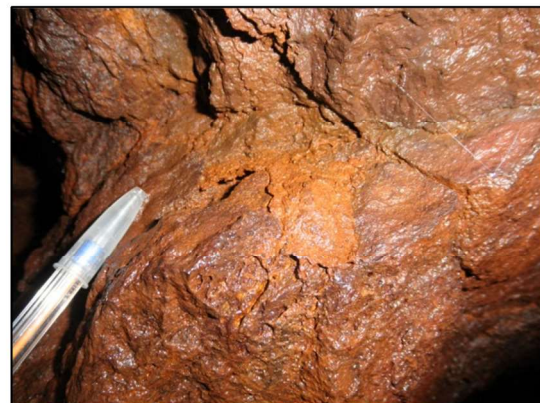
Figura 74: Detalhe de porção da parede com formação de crosta de óxido-hidróxido com presença de umidade por condensação.
