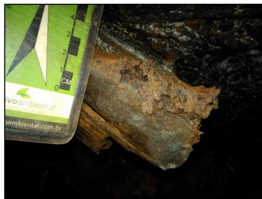
Figura 60: Escorrimento em pendente do teto.
