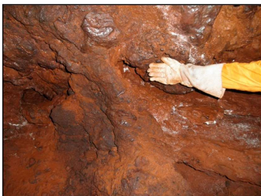
Figura 75: Vista de parede tomada por crosta de óxido-hidróxido com presença de alvéolos.
