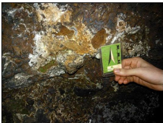
Figura 83: Crosta branca existente no teto.
