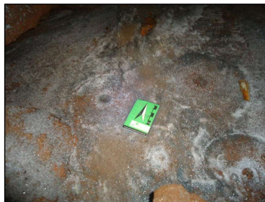
Figura 30: Porção do piso com acúmulo de “pó de especularita” com marcas de gotejamento e de poças temporárias.
