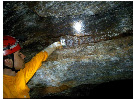
Figura 96: Fratura no teto de passagem entre os salões da cavidade.
